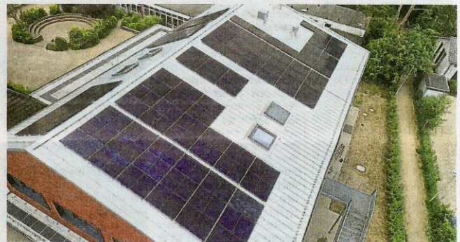
Das Dach der Grundschule Waldschule in Quickborn-Heide trägt 111 Solarmodule, die in der Spitze etwa 46.000 Kilowattstunden Strom pro Jahr erzeugen können.
